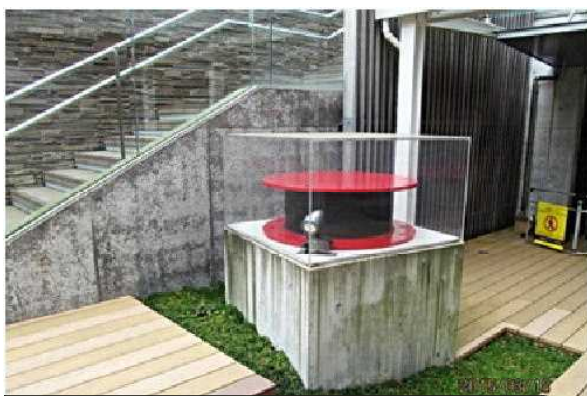
市役所地下外広場に設置されている免震装置
