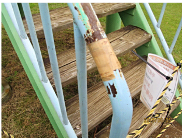
錆びて穴の開いているところをガムテープで補修
