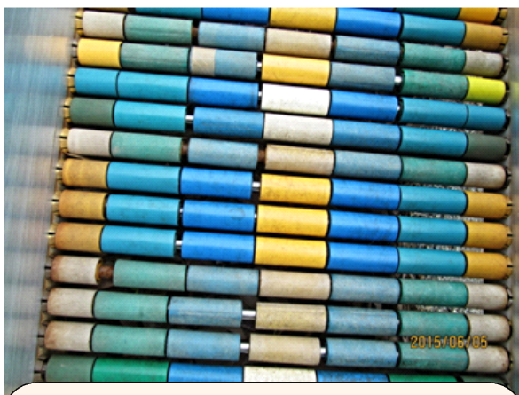
錆びたローラーシャフトもある。プラローラーも劣化
