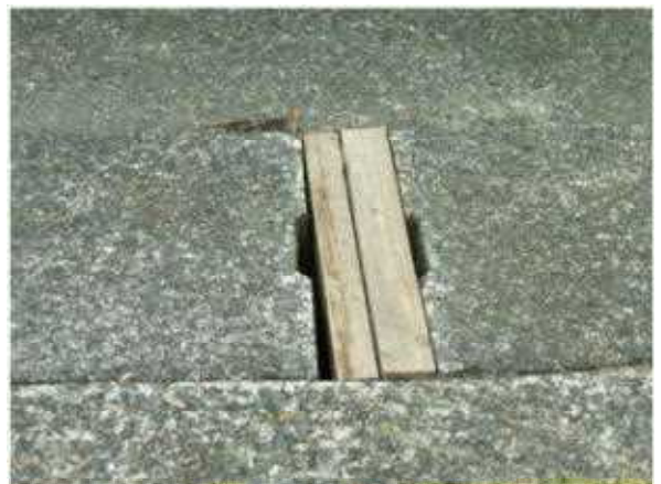
補修後 木片で隙間を埋めて応急修理
