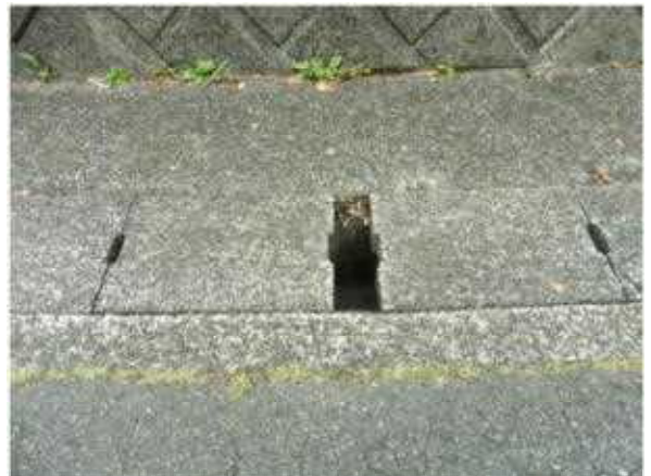
補修前 側溝蓋に大きな隙間があります
