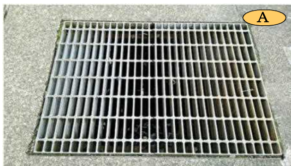
古いグレーチング。
